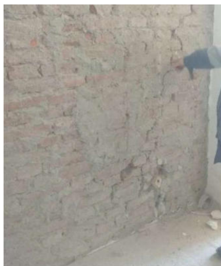
Pukotine širine veće od 10 mm
